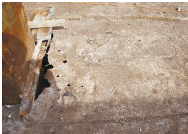
Иногда состояние плит настолько плохое, что необходим полный демонтаж кровельного пирога с частичной или полной заменой ребристых плит.
