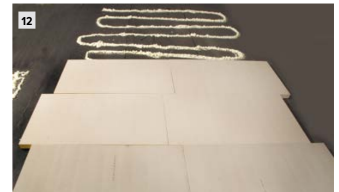
12 Оптимальный вариант — вести работу захватками, постепенно нанося пену и закрывая ее плитами LOGICPIR PROF CXM/CXM.
